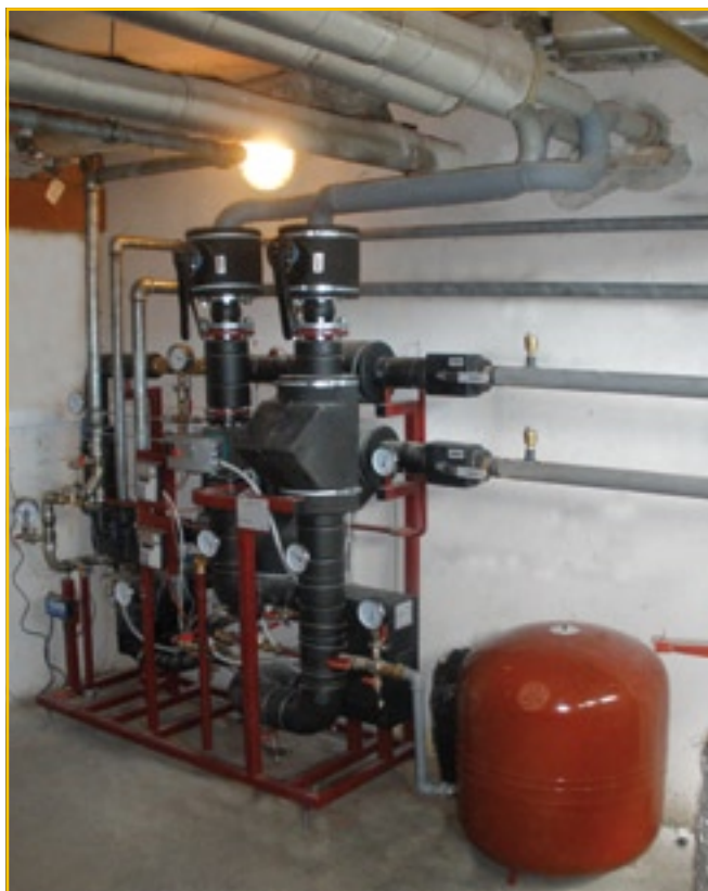
Житлові теплообмінні станції
