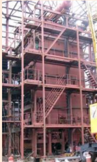
Котел компанії “Енергомашпроект”
