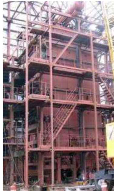
Котел компанії "Енергомашпроект"
