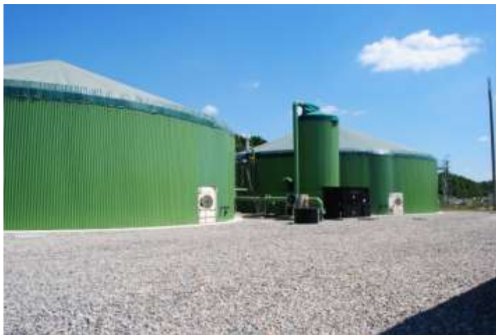
Биогазовая установка в с.Копанки
