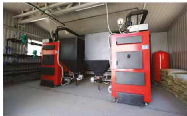
Рисунок 26– Блочно-модульна котельня ЗОШ І-ІІІ ст. у с. Княжичі, Київської обл.
