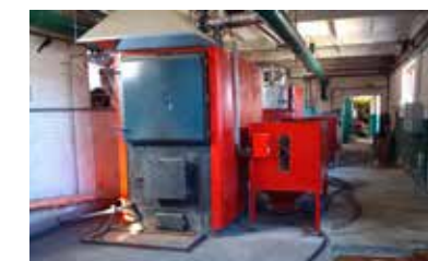
Рисунок 13 – Котельня на твердому паливі (м. Жашків, вул. Миру, 7а)
