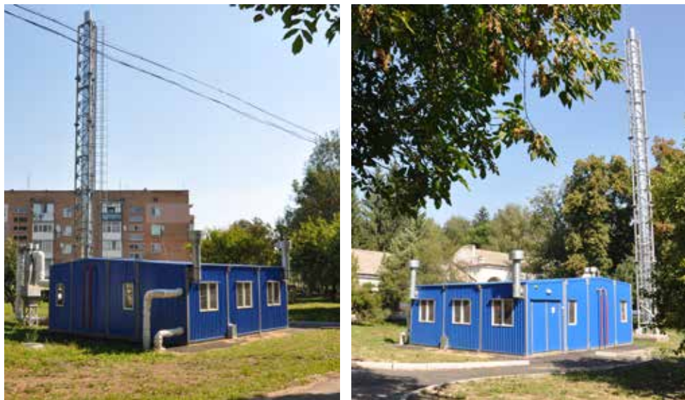
Рисунок 11 – Загальний вигляд котельні на біопаливі (м. Знам'янка, вул. Калініна, 113)
