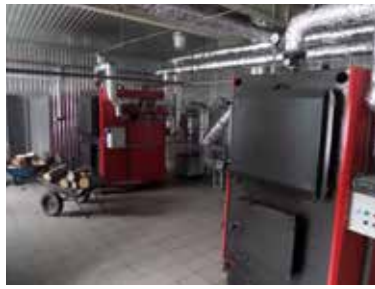
Рисунок 20 – Котельня загальноосвітньої школи №1 м. Щорс, Чернігівська обл.
