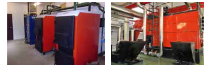
Рисунок 7 – Загальний вигляд біопаливної котельні та котла з допоміжним обладнанням 11
