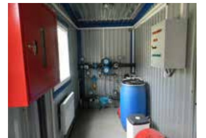
Рис. 19 –Блочно-модульна котельня в м. Дубно по вул. Венецькій, 11а
