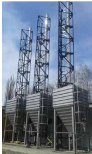
Рис. 17 – Модульна котельня на твердому паливі (с.мт. Чкаловське, Харківська область)
