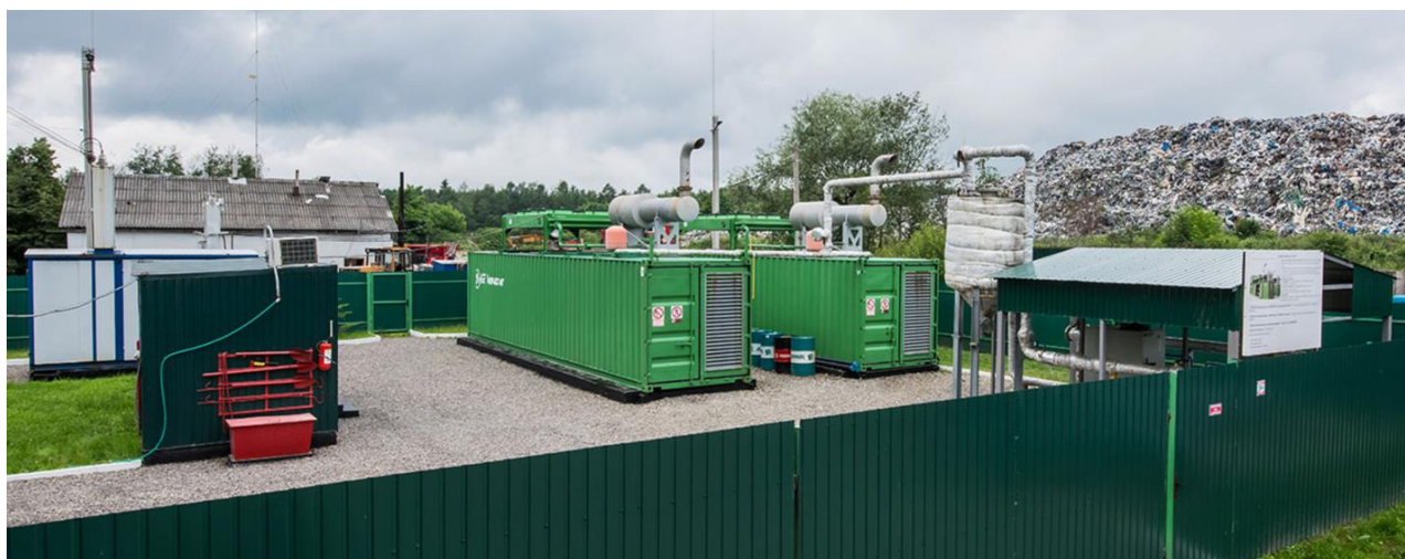
Рис. 4. Впроваджена електростанція потужністю 600 кВт на біогазі зі звалищ ТПВ в м. Івано-Франківськ.
