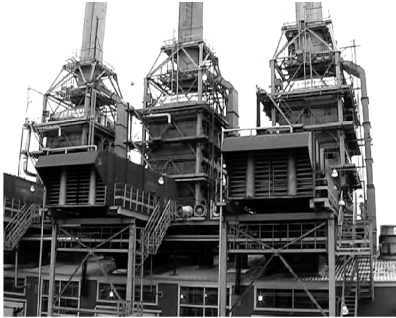
Рис. 4.54. Общий вид котлов-утилизаторов КУВ-30 башенной конструкции производства АК «Южтрансэнерго».
