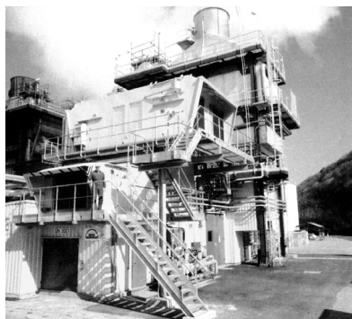
Пэкедж с газотурбогенератором FT8 и реконструированным КУ.
