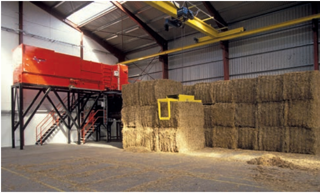
Склад соломи на станції централізованого теплопостачання Terndrup. Солома переміщується зі сховища до котла краном з автоматичним управлінням. Склад вміщує обсяг соломи, достатній для роботи станції протягом одного тижня в зимовий період. СВІТЛИНА Torben Skøtt, BioPress.
