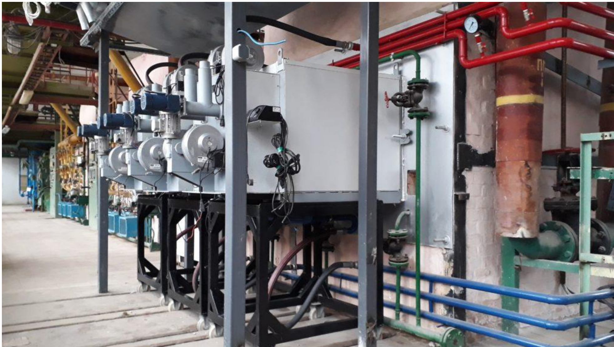
Котел КВГ-7,56, переобладнаний для спалювання гранул
