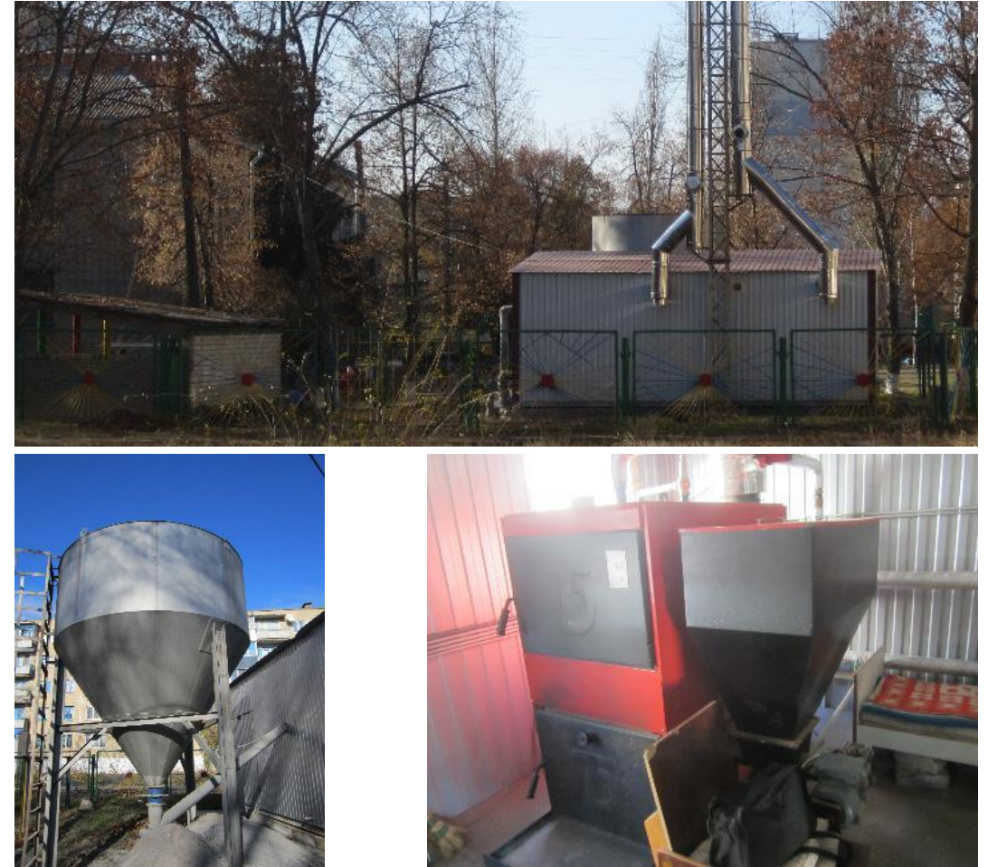
Місто Купянськ, 2016-2017 роки, котельня на пелетах 0,3 МВт, опалює дитячий садок
