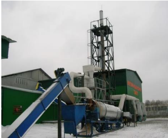
Івано-Франківськтеплокомуненерго, 2008 рік, 3,4 МВт, паливо-деревна тріска. Переведено 2 котли Е-2,5-0,9 на біомасу
