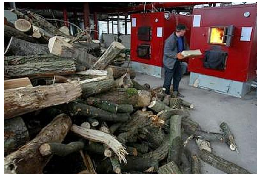
Котельня на дровах в м. Ірпінь (реконструкція існуючої котельні)
