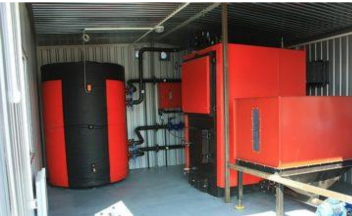
Теплоакумулятор в блочно-модульній котельні
