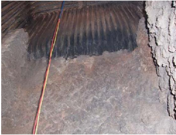
Відкладення всередині топки
