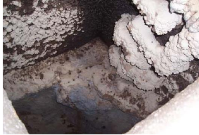
Відкладення на трубах
