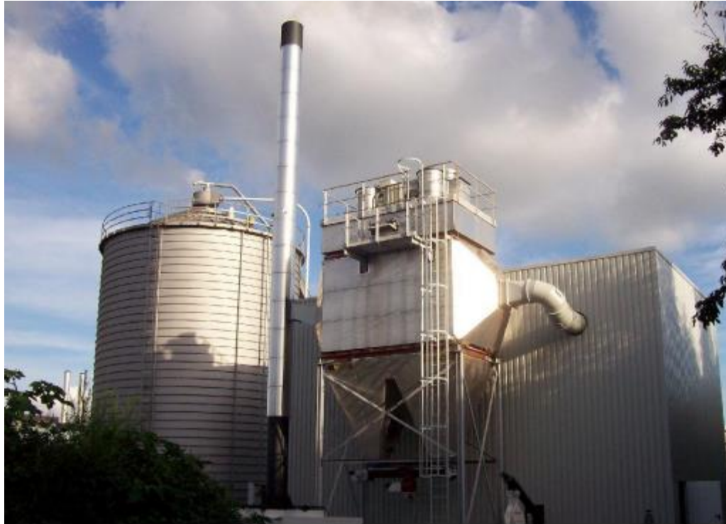
Сухий електрофільтр (KARA)
