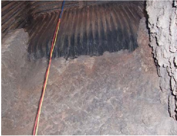
Відкладення всередині топки
