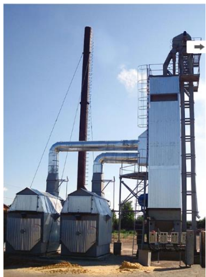
Зерносушильний комплекс КС-16 компанії «БРІГ»
