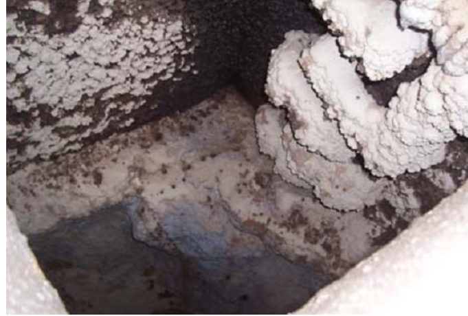
Відкладення на трубах
