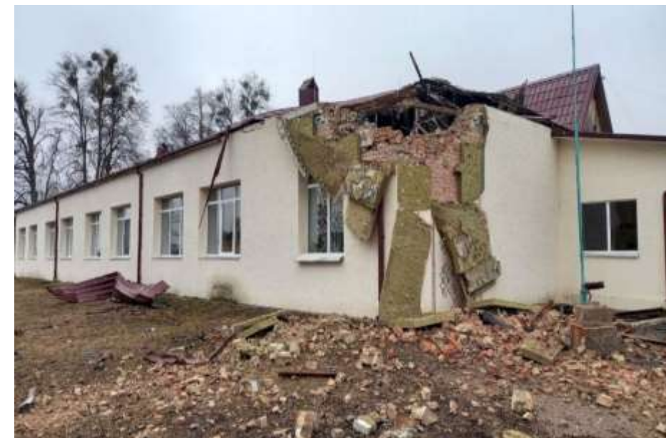
Зруйновані шкільні будівлі у Микуличах (2022) та проект нової NZEB-школи
