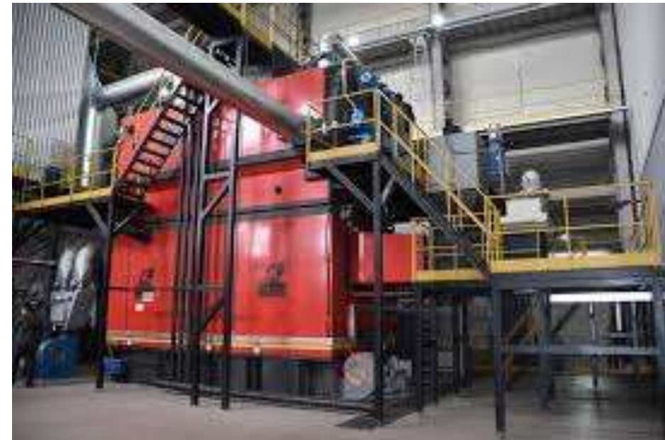
Котельня на біопаливі КП «Теплоенерго» (тендерна документація та новини НЕФКО)
